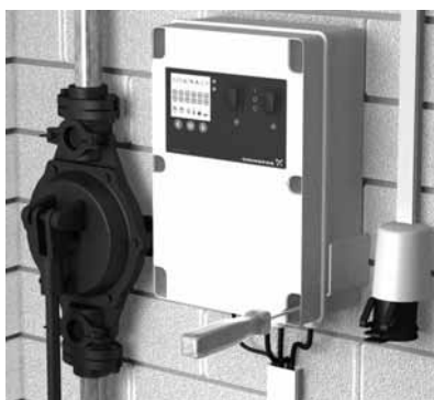
Abb. 10 Anbringen der Steuerung LC 221
